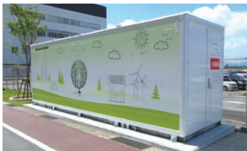
蓄電池コンテナ(徳島工場)
