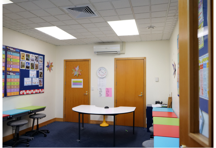
เครื่องผลิต nanoe™ X Air-e แบบติดเพดานที่ติดตั้งในห้องเรียนของ St Cuthbert's College
