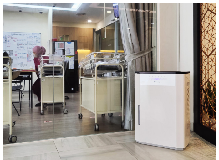
ziano™ เครื่องขยับยั้งเชื้อโรคในอากาศจาก Panasonic ที่ติดตั้งในห้องพักของศูนย์ Byond28 Confinement Care
